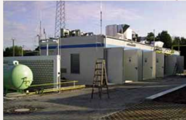
Unité d'injection de RWE AG à Kerpen (Allemagne)
