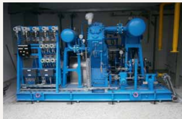
Unité d'injection de Zittau (Allemagne)
